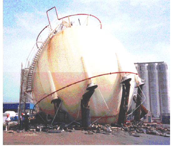
التآكل يهاجم الدعامات البناء
