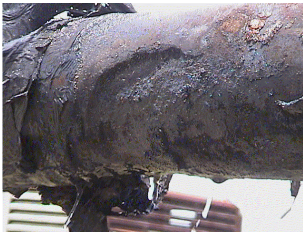
Corrosão ataca tubagem
