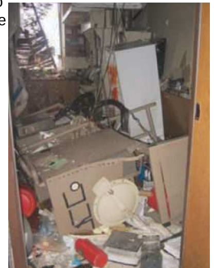
Daño en el Laboratorio
