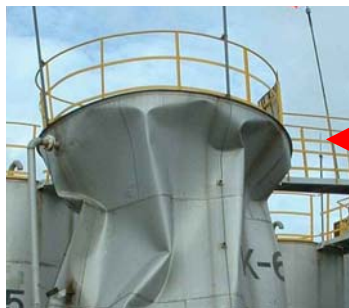
Janeiro: Colapso de Tanque
