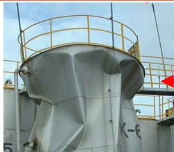
Январь: Разрушение емкости под вакуумом
