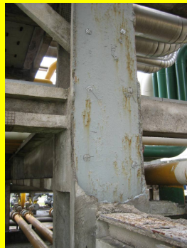
5月號 - 管橋支柱 之防火材(被覆)受損
