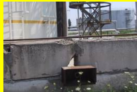
6月號 - 儲槽區防溢堤 牆上的破洞
