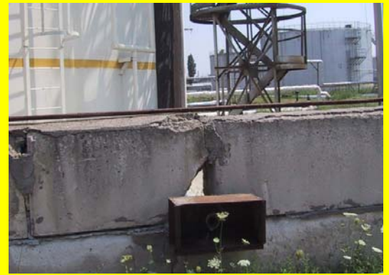
Juni – een gat in de muur van een tankput
