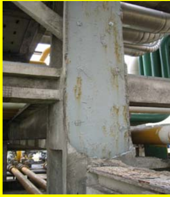
Mei – beschadigde brandprotectie op een staander
