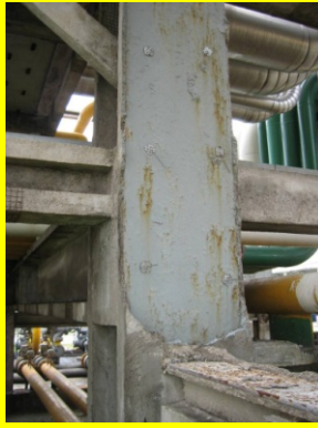
Mai – dommage à la protection ignifuge sur des supports de râteliers
