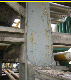
Μάιος – φθαρμένη πυροπροστασία στηρίγματος σωληνώσεων
