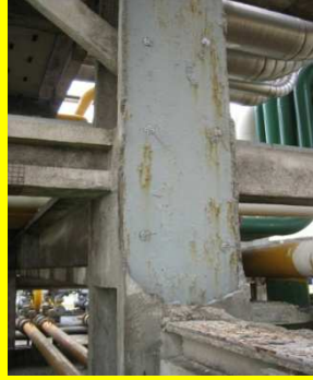
मे – पाइप ब्रीजला आधार देणाऱ्या स्तंभाचे खराब झालेले अग्निरोधन
