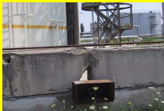
Czerwiec – dziura w ścianie opaski zbiornika magazynowego
