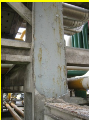
Maj – zniszczone zabezpieczenie ogniochronne na kolumnie estakady rurociągów
