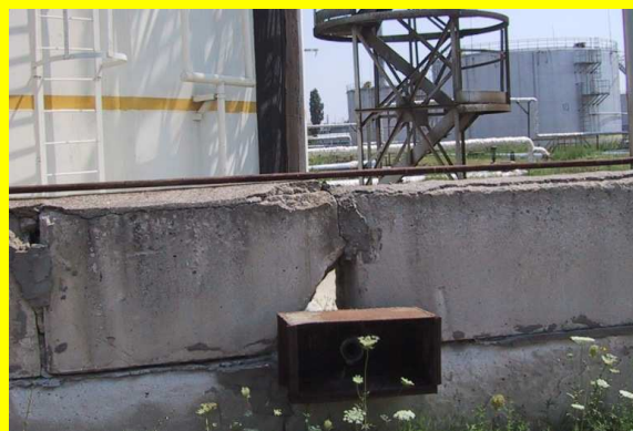
Junho – um buraco em uma parede de um dique de contenç o de um tanque
