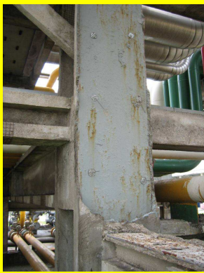
Maior – “fireproofing” danificado em uma coluna de suportaç o de uma estrutura para tubulaç es
