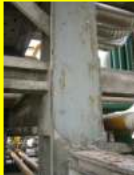
Mayo – protección contra incendio dañada en una columna de soporte de un puente de cañerías
