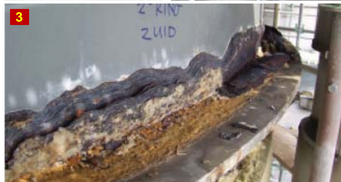
(1) og (2) – Eksempler på beskadiget isolering (3) – Korrosion p.gr.a. beskadiget isolering
