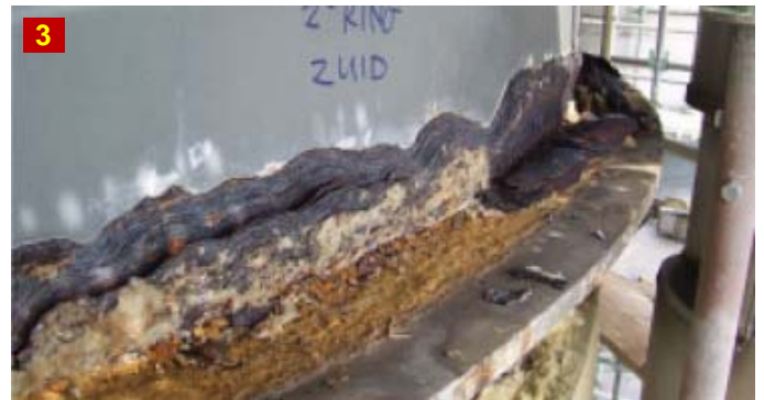
(1) en (2) – Voorbeelden van ondeugdelijke isolatie (3) – Corrosie als resultaat van beschadigde isolatie
