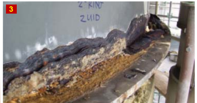
(1) und (2) – Beispiele für schadhafte Isolierungen (3) – Korrosion infolge beschädigter Isolierung
