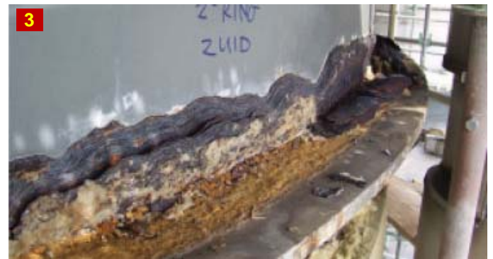
(1) e (2) Esempi di coibentazioni danneggiate (3) – Corrosione derivante da danni all'isolamento
