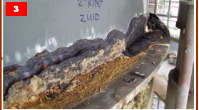
(१) आणि (२) – खराब इन्सुलेशनाची उदाहरणे (२) – इन्सुलेशन खराब झाल्यामुळे लागलेला गंज
