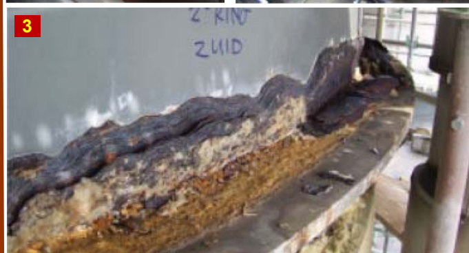
(1) i (2) – Przykłady uszkodzeń izolacji (3) – Korozja powstała na skutek uszkodzeń izolacji
