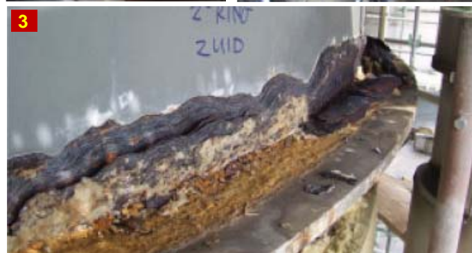
(1) e (2) – Exemplos de isolamentos danificados (3) – Corrosão resultante de isolamento danificado
