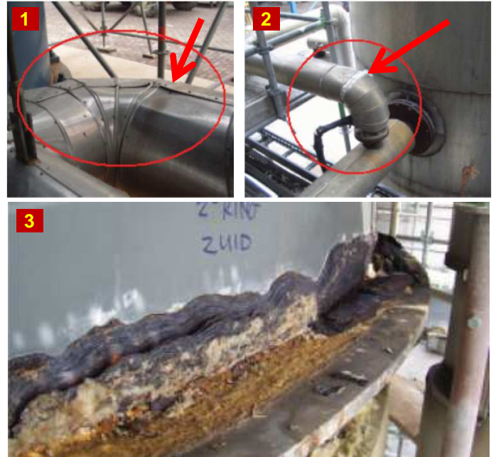
(1) e (2) – Exemplos de isolamento danificado (3) – Corrosão resultante de isolamento danificado.
