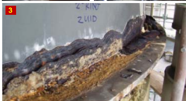
(1) och (2) – Exempel på skadad isolering (3) – Korrosion orsakad av skadad isolering
