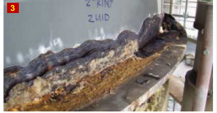
(1) ve (2) – Hasarlı izolasyon ile ilgili örnekler (3) – Hasarlı izolasyon sonucu korozyon
