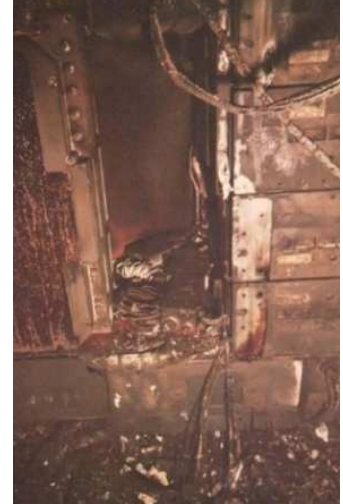
Yangın sonrası KM'nün iç kısmı
