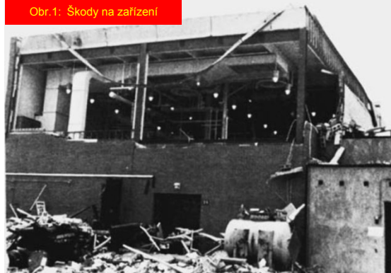
Obr. 1: Škody na zařízení
