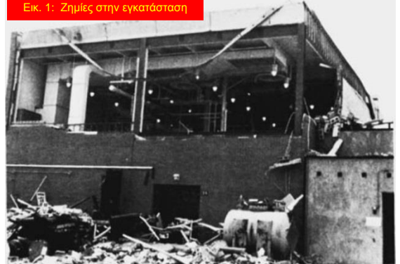
Εικ. 1: Ζημιές στην εγκατάσταση
