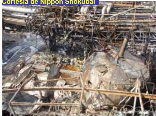
Foto 1: Dipòsit d'AA destruït
