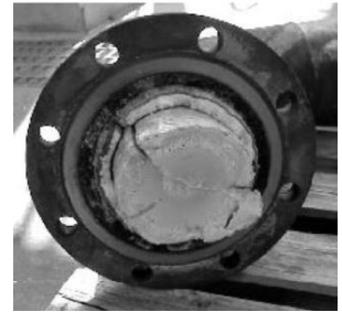
Fig. 1 Conduite d'évent bouchée
