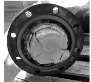
איור 1: קוונט סתום
