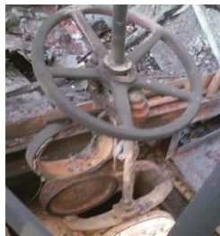
图3 事故发生后的管道盲板阀
