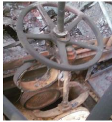
Figuur 3 Blindklep na het incident
