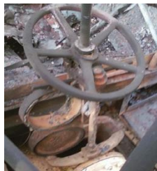
شکل ۳ محل مسدود بودن مسیر پس از حادثه
