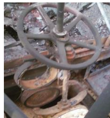
図3 事故後の 閉止板バルブ
