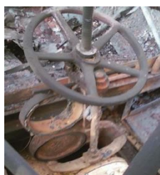
Rysunek 3 Miejsce odcięcia zaślępką po zdarzeniu
