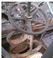
Figura 3 Blinda ochelar de pe conductă după incident
