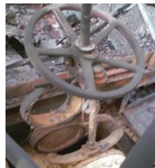
รูปที่ 3 Line blind หลังเกิดเหตุการณ์
