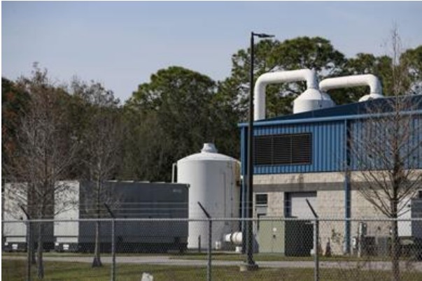
Abbildung 1: Wasseraufbereitungsanlage in Oldsmar, Florida, USA
