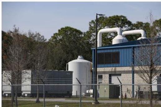
Zdjęcie 1. Oldmar, Floryda, instalacja uzdatniania wody
