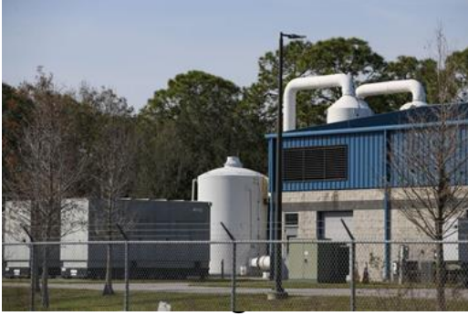
Şekil 1. Oldsmar, Florida su arıtma tesisi
