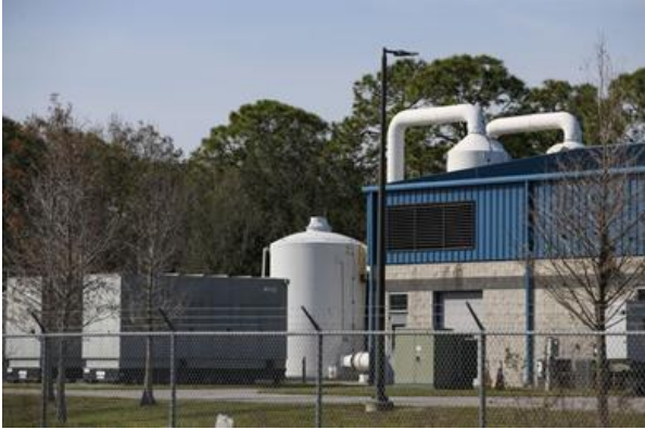
Hình 1. Nhà máy xử lý nước Oldsmar, bang Florida
