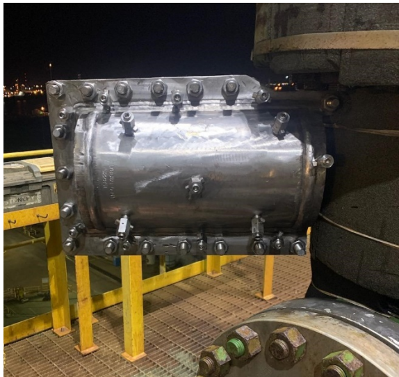
Bild 1. En tillfällig rörklamma över en ventil som läckte
