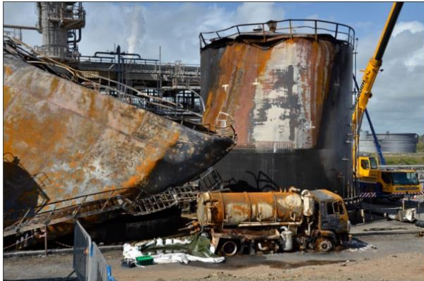
Figura 1. Rescaldo da explosão e incêndio
