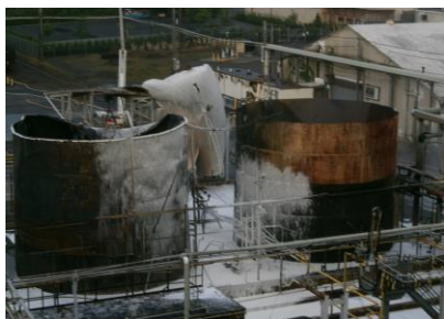
Фигура 2. Резервоари след пожара
