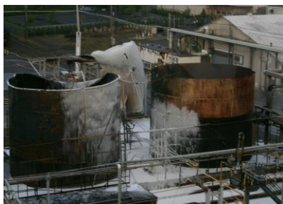
Foto 2. Zbiorniki po pożarze
