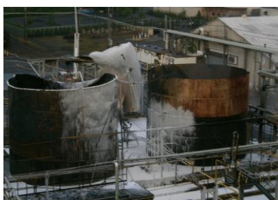
Рис. 2 Резервуары после пожара
