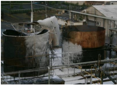
รูปที่ 2 สภาพถังหลังเกิดเพลิงไหม้
