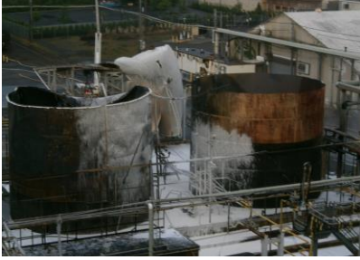
Şekil 2. Yangın sonrası tanklar
