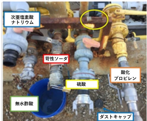
図1: MGPI社の化学物質タンクへの接続部。金属フレーム上に硫酸充填ライン用の南京錠(丸で囲んだ部分)が置かれ、地面に次亜塩素酸ナトリウムの防塵キャップが落ちたまま。(CSB report 2017-01-I-KS 参照)
