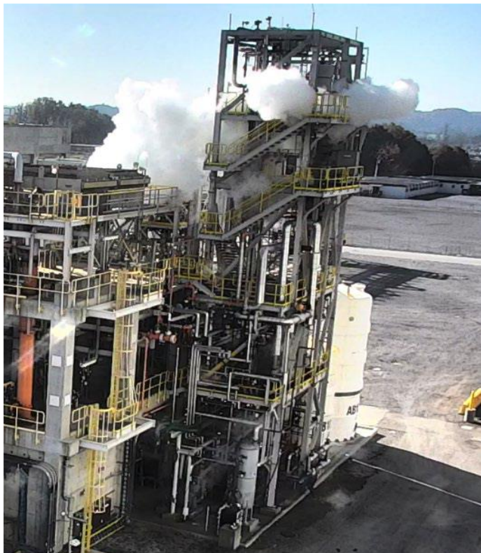
Figuur 1. Die platform waar die HCl lek gebeur het.. Vyftien sekondes later was die hele struktuur vol gas. (Ref CSB report No. 2021-01-I-TN)
