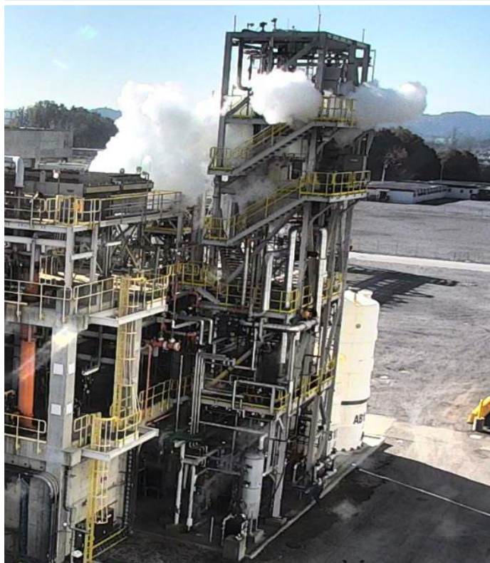
Obrázek 1: Provozní jednotka, kde došlo k úniku. O patnáct sekund později konstrukci zahalil mrak plynu. (Zdroj: Zpráva CSB č. 2021-01-I-TN)
